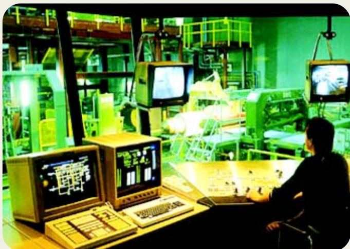
变频器监控系统
