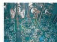
电气机械内部
